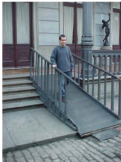
Figura 6: Rampa de acesso ao Museu da República: inclinação e posicionamento inadequados
